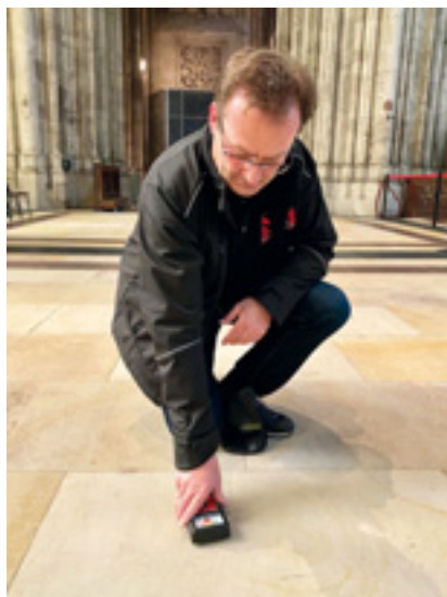
Nur im Mittelschiff ist die Feuchtigkeit derzeit unkritisch, so Stefan Jedersberger.
